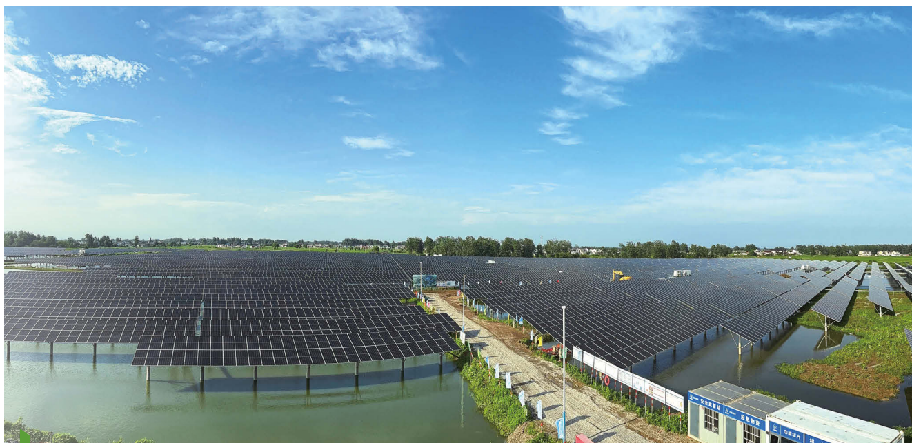
位於江蘇省新建的揚州公道太陽能光伏電站配備8兆瓦商用電池儲能系統，屬全省首例。
